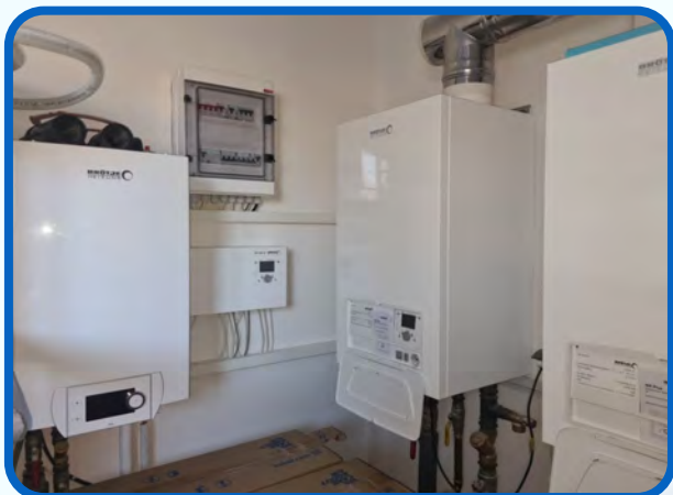
Kotłownia hybrydowa w Nakle przy ul. Dworcowej 24a
